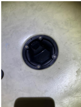
Plastsluk, skrudd til belegg. Belegget i området rundt sluk har sluppet festet til underlaget.
