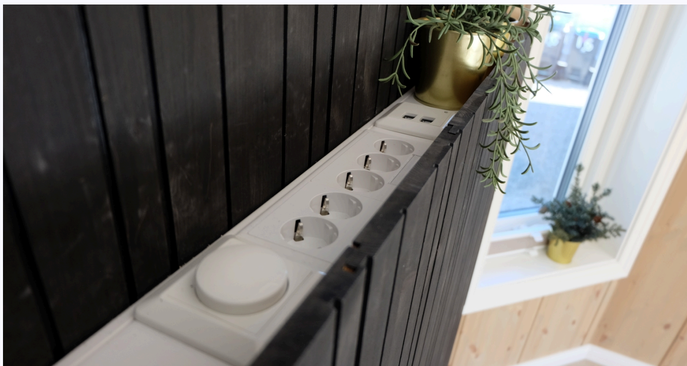
10 skjulte stikkontakter og 2 ethernet
