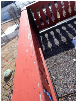
Viser rekkverk med værslitasje.
