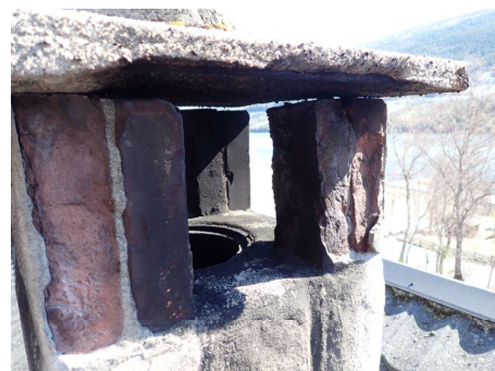
Viser knaster på topp av pipe med avskallinger.
