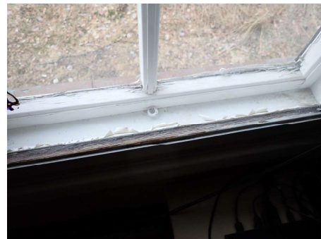
Viser en av de eldste vinduene med værslitasje.
