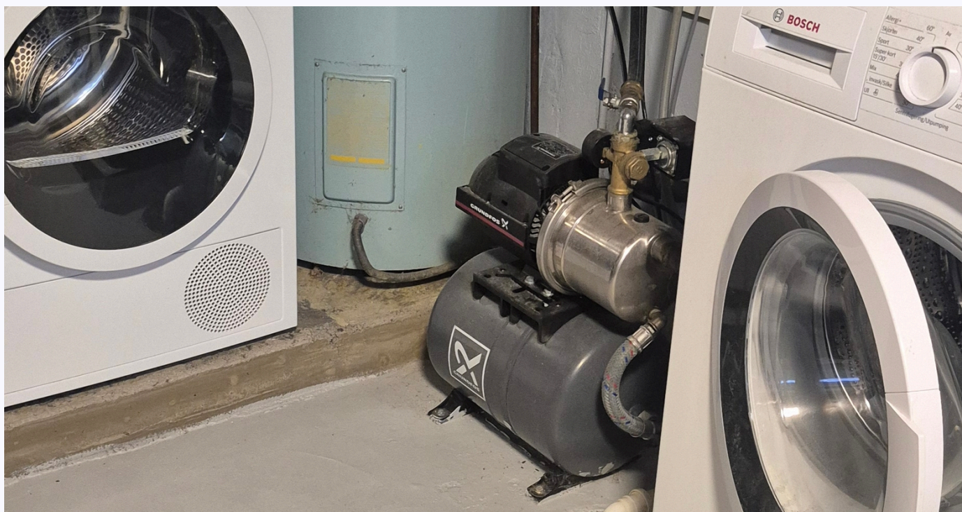
Vaskerom /teknisk rom
