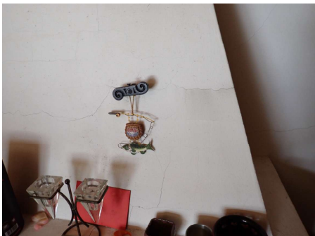
Viser peiskappe med riss/sprekker.
