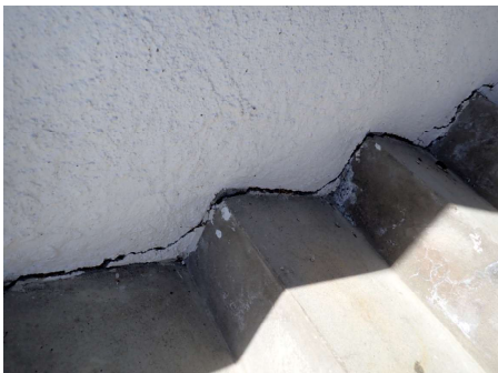
Viser sprekk i grunnmur langs trapp.
