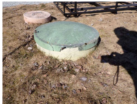
Viser skadet lokk.
