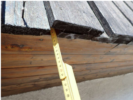
Viser manglende musetetting bunn av kledning.
