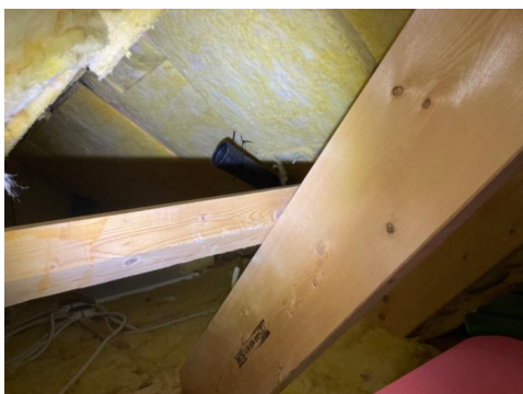
Uferdig avslutning av luftrerør.
