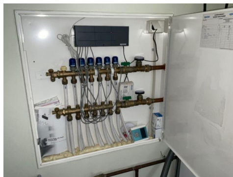
Fordelerskap for vannbåren varme.
